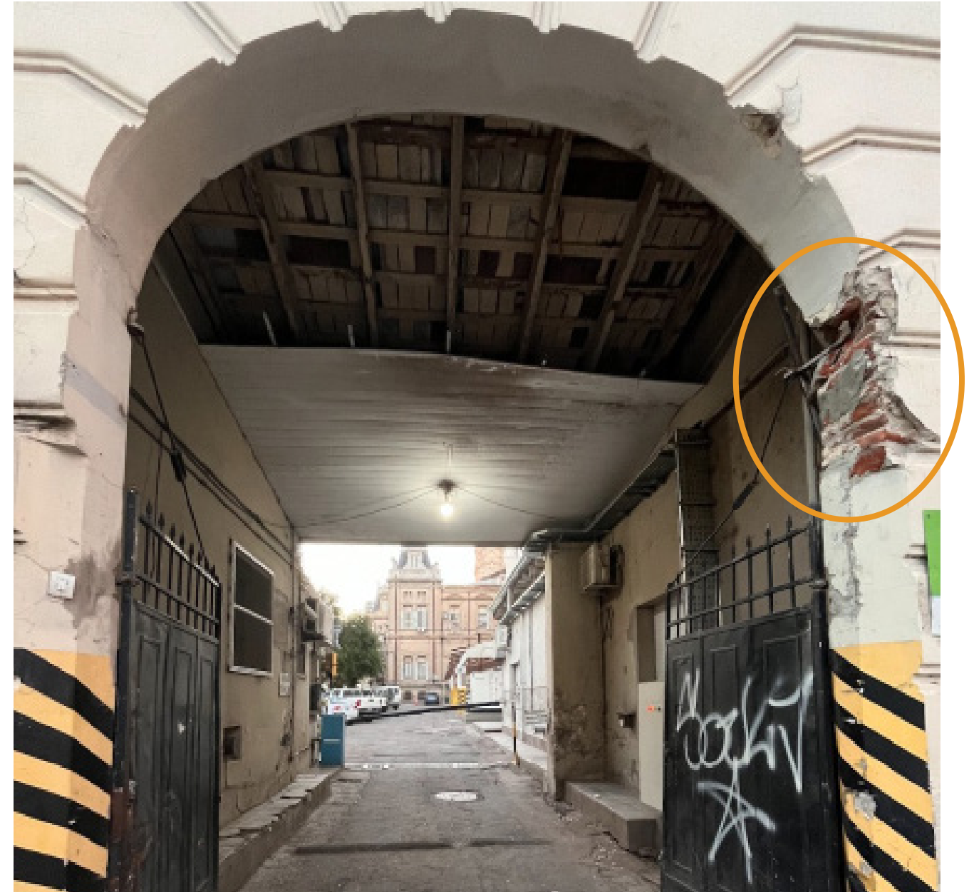
DESPRENDIMIENTO DE MASA MURARIA
