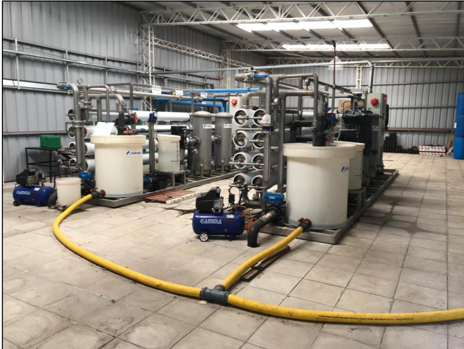
Figura 8.4.1.2. Planta de ósmosis inversa utilizada para el tratamiento del agua del campo de bombeo La Morocha.
