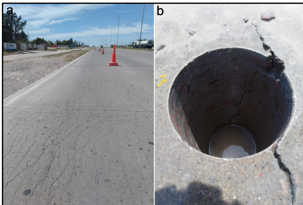
Figura 6.12 Autovía Juan Pablo II a) superficie del carril descendente; b) hueco originado por la extracción de un testigo (nótese que la fisura atraviesa el espesor del mismo)
