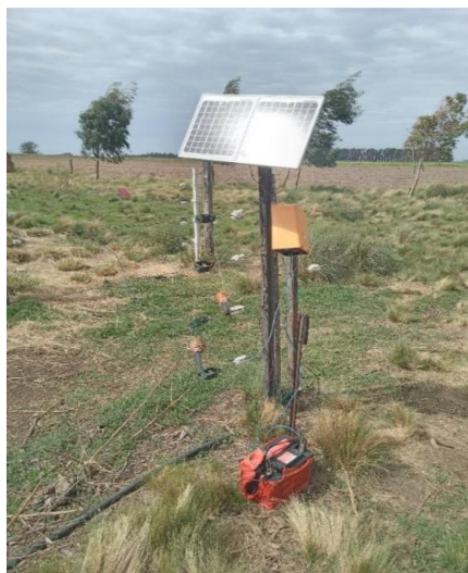
Figura 7. Pantalla solar para electrificación
