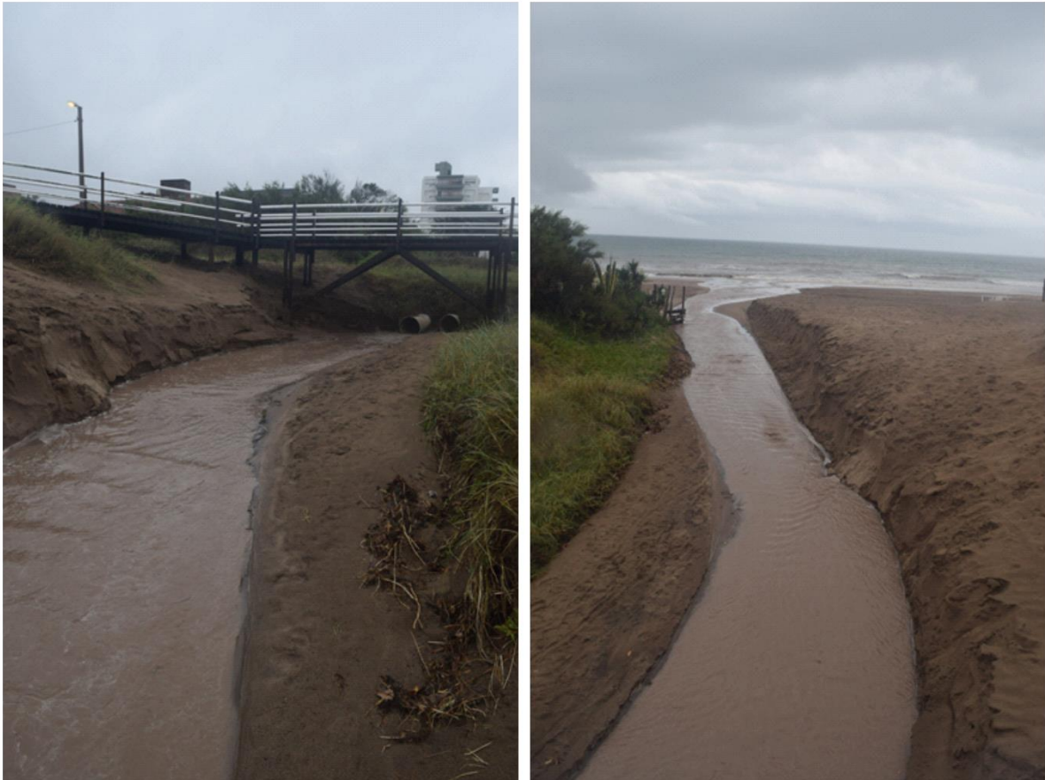
Figura 6.28. Desagüe pluvial canalizado a la altura del Paseo 118 (37°16'19.86"S, 56°58'35.75"O), Villa Gesell. Fuente: imagen de archivo propio correspondiente a febrero de 2022.
