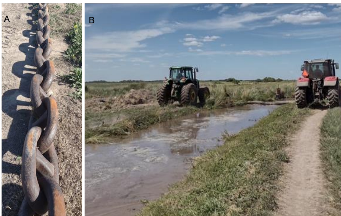
Figura 18. A: Cadena utilizada para eliminar lama; B: Tractores realizando la limpieza de un canal con cadena.
