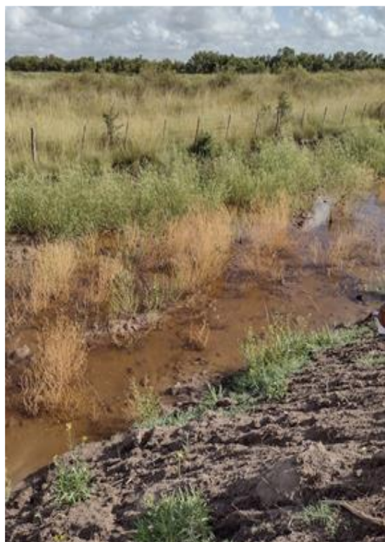
Figura 13. Rotura en canal secundario "El Puma" que generaba filtraciones
