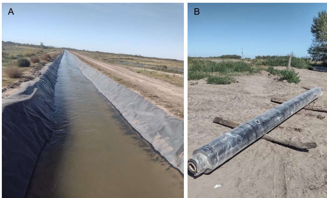
Figura 6. A) Tramo impermeabilizado del canal secundario “El Puma”; B) Rollo de geomembrana
