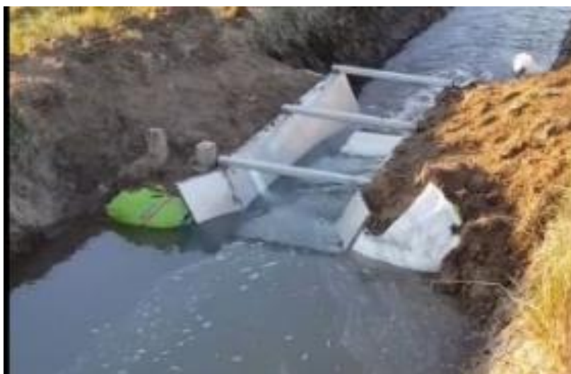
Figura 14: Medición de caudales (Aforador RBC)
