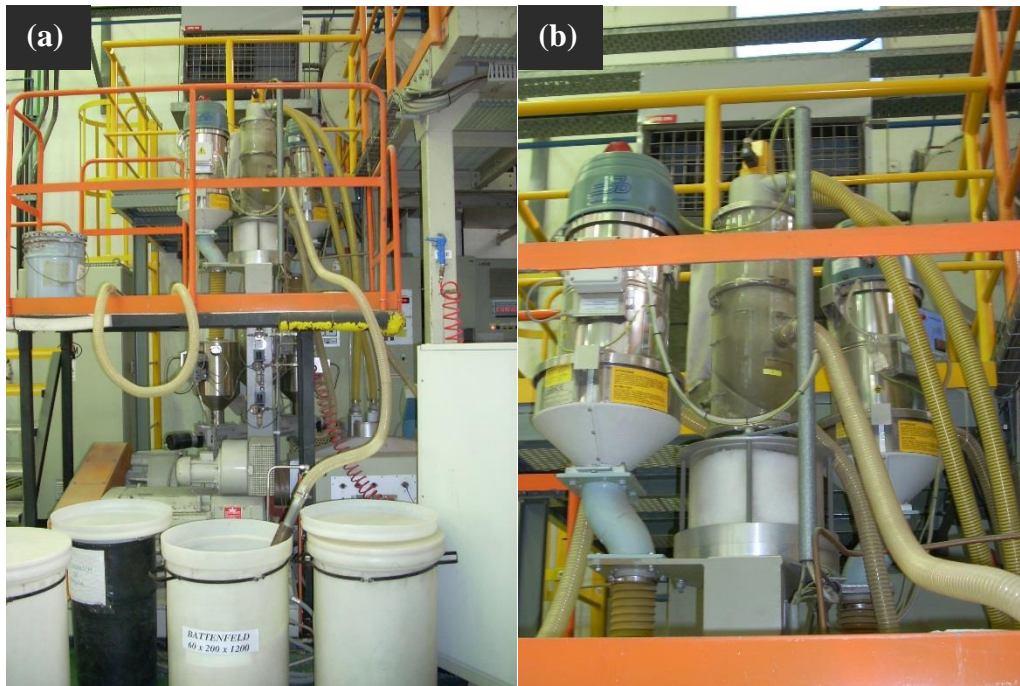
Figura 5.5 (a) y (b) Dosificador y mezclador de pellets.
