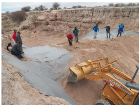
Figura 2. 3. Construcción de azud en la zona cercana a San Miguel (Figura 2.1). Consultado de: Wetlands International LAC. (2021).
