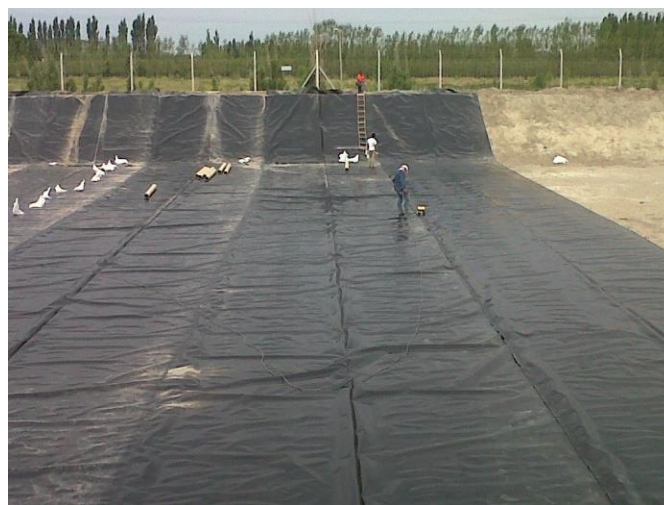
Figura 2.32: Reemplazo de geomembrana por varias roturas.
