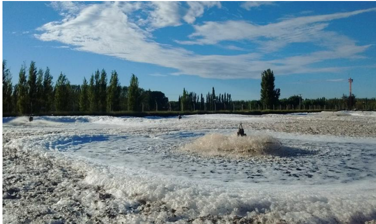
Figura 2.28: Generación de espuma en la laguna de tratamiento.
