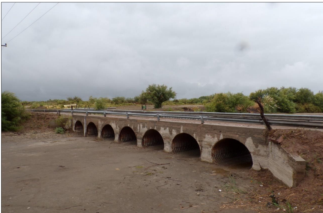
Figura 105: puente viejo en Algarrobo del Águila, cauce seco cubierto con sedimentos. Fuente: Langhoff (2018).
