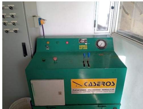
Figura 17: Comando hidráulico de plataforma elevadora
