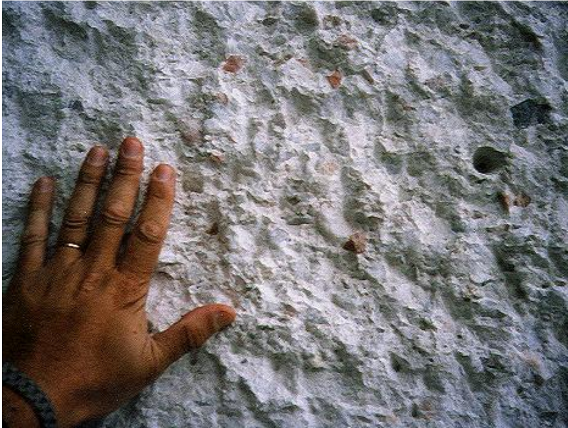
Figura N° 1. Agregados gruesos expuestos en un hormigón blanco
