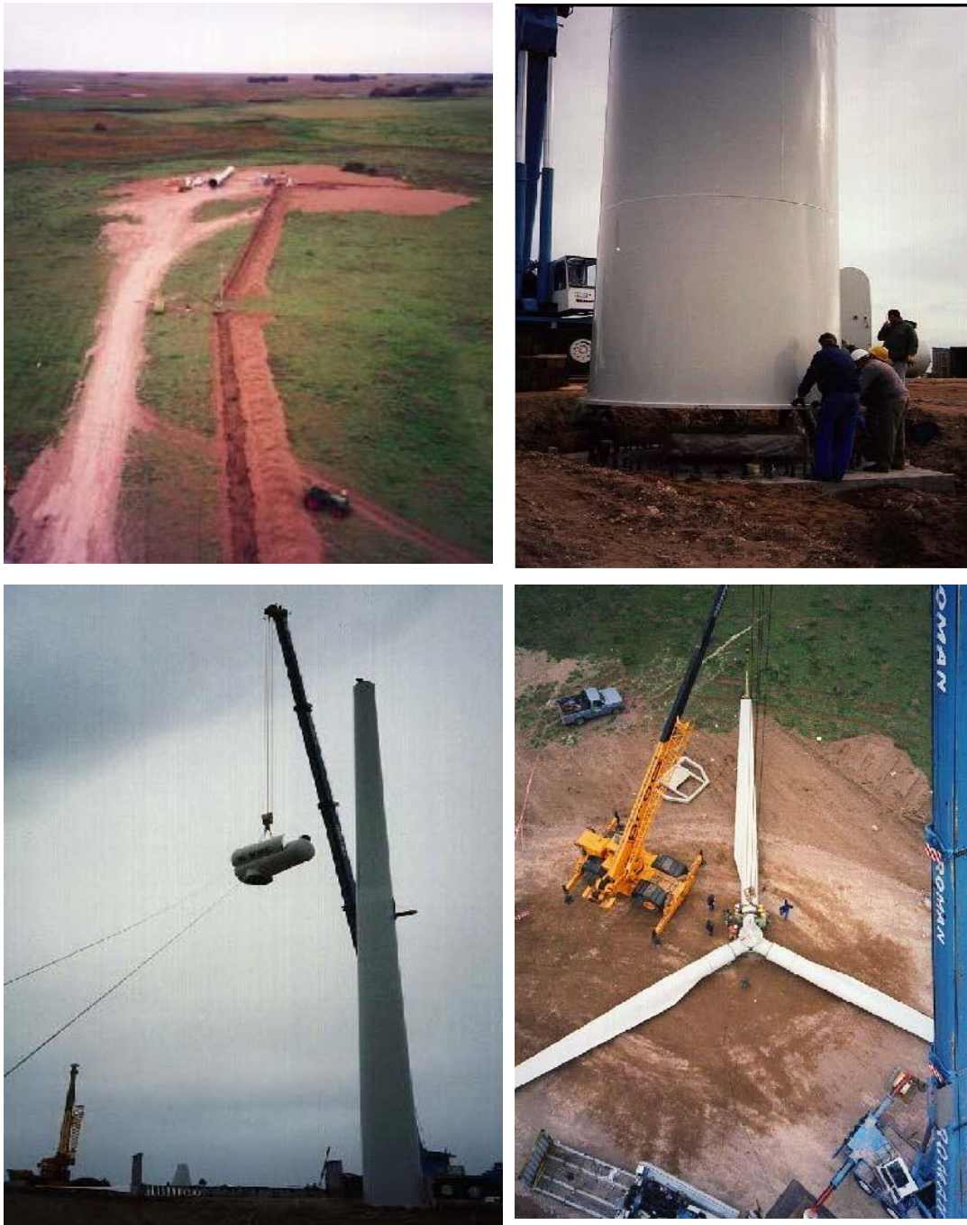
Figura N° 74. Proceso de montaje de los aerogeneradores del parque eólico de Mayor Buratovich. Año 1997. Fuente: Di Prátula, 2015.
