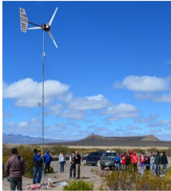
Figura N° 19. Aerogenerador de baja potencia en escuela rural de Malargüe, provincia de Mendoza.
