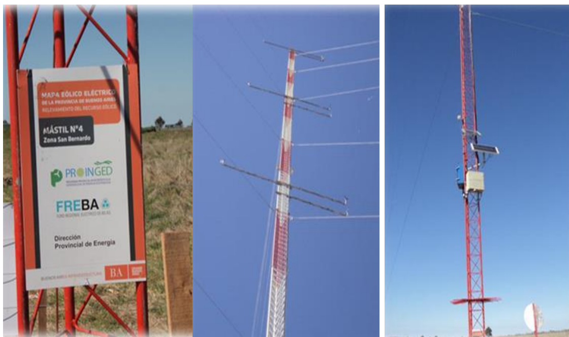
Figura N° 42. Torre de medición de vientos en San Bernardo, provincia de Buenos Aires.
