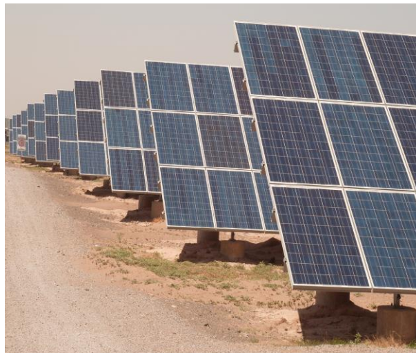
Parque Solar Fotovoltaico Cañada Honda, San Juan. Fuente: Carrizo, 2015.
