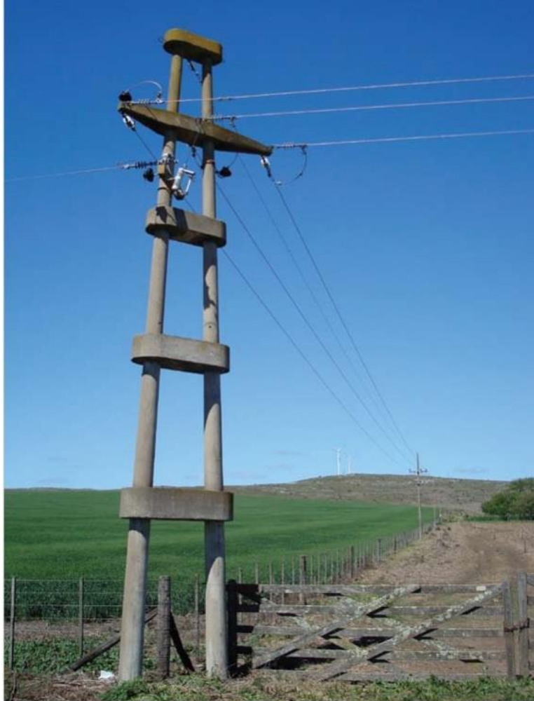
Figura N° 77. Línea de 13,2 kW que conecta el Parque Eólico a la red local de CRETAL.
